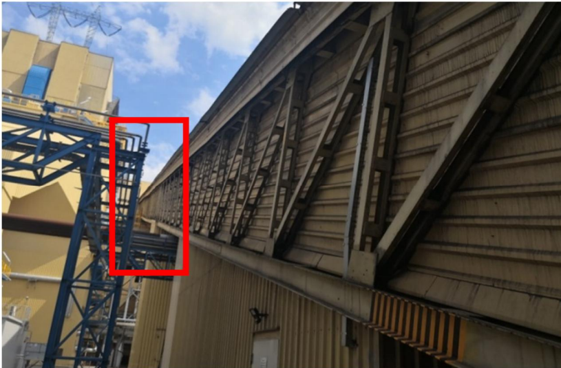
Rys. 7. Ugięcie dolnego pasa bocznej, podłużnej kratownicy ściennej.
